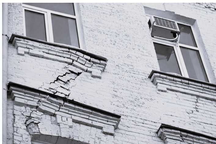
Fissure sur un immeuble dans le centre de Kyiv, provoquée par des travaux de construction dans le sous-sol. © Quotidiano.net
