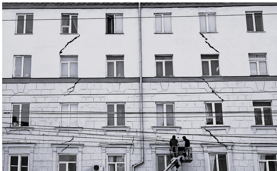
Fissures sur des immeubles à Kyiv dues à l'affaissement des façades et à l'instabilité des sols. © Georesin
